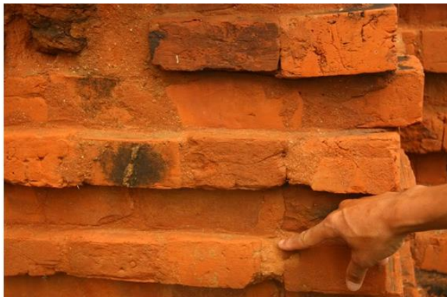
Hình 3.8. Vết vữa phục chế khá lộ liễu tại Tháp Poklong Giarai-Ninh Thuận. (Nguồn: Tác giả)
