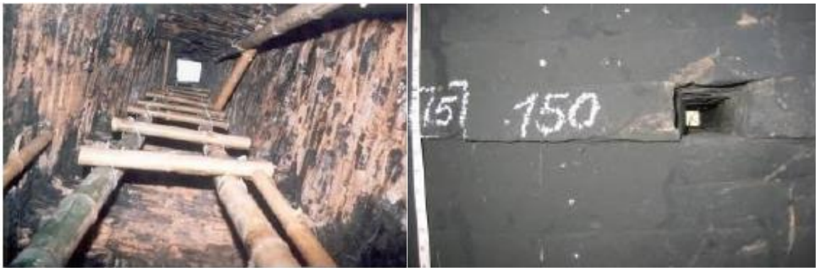
Hình 2.28. Lỗ thông trên đỉnh đền tháp Dương Long-Bình Định và Lỗ thông ở mặt tường mái đền tháp Nam Hoà Lai--Ninh Thuận
