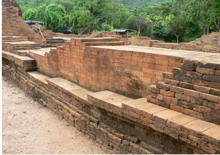
Hình 3.6. Hình ảnh trùng tu đền tháp tại Mỹ Sơn năm 2008 bằng phương pháp mài chập. (Nguồn: Trung tâm bảo tồn di tích Quảng Nam)
