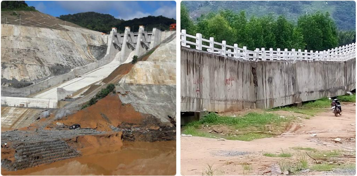
Hình 1-2: Sự cố tại Thủy điện Sông Bung 2 và Sông Dinh 3 (nguồn Internet)
