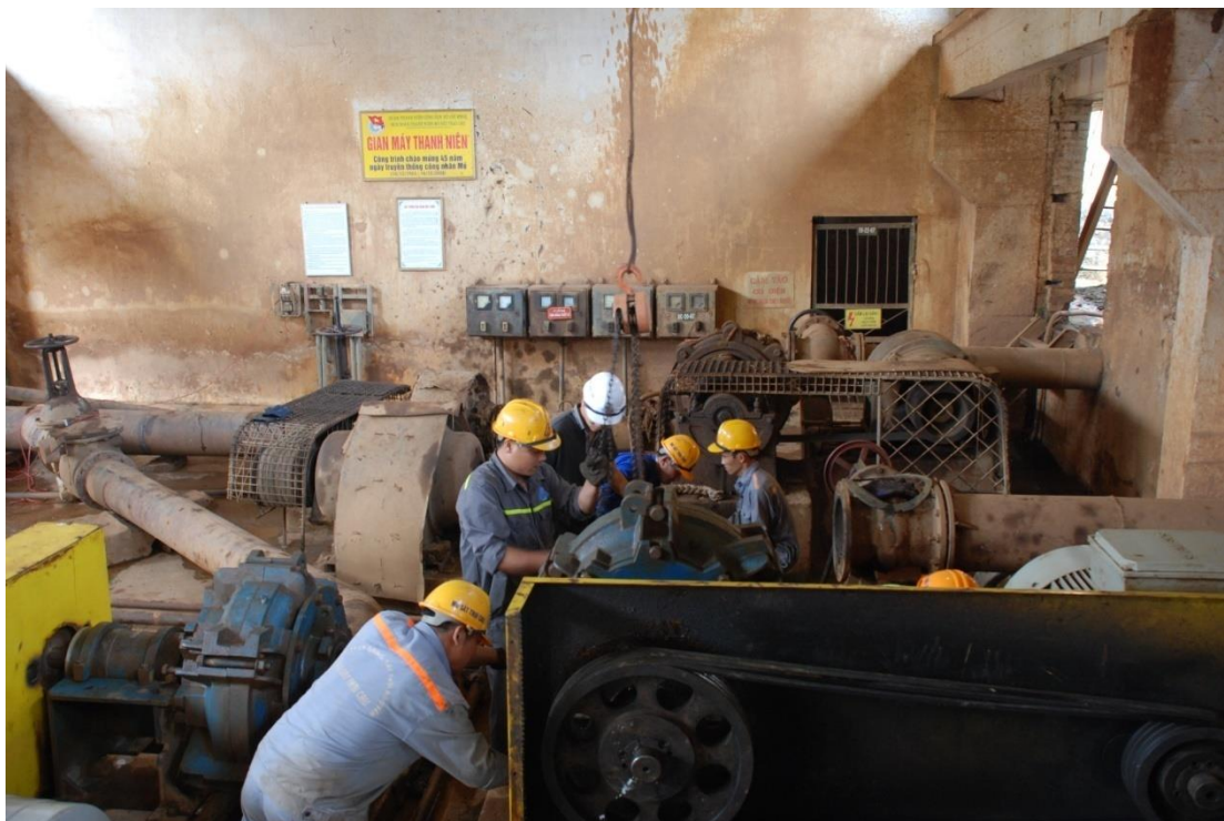
Công nhân sửa chữa tại hầm bơm cát (Nguồn: Kỷ yếu 50 năm truyền thống mỏ sắt Trại Cau)
