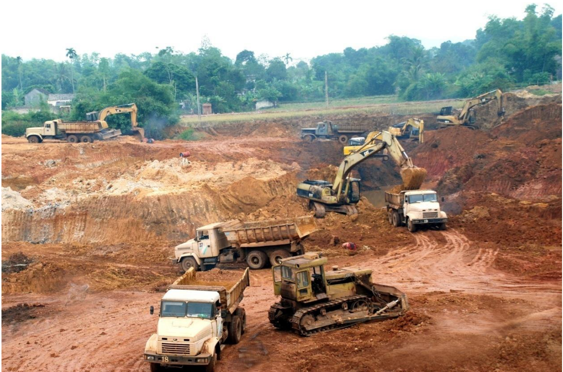
Một góc sản xuất của Phân xưởng Khai thác tại Khu vực tầng sâu núi quặng (Nguồn: Kỷ yếu 50 năm truyền thống Mỏ sắt Trại Cau)
